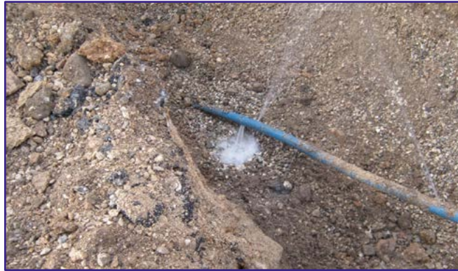
Şekil 1.5. Su kayıplarının büyük bir kısmı genellikle servis bağlantılarında oluşur.
