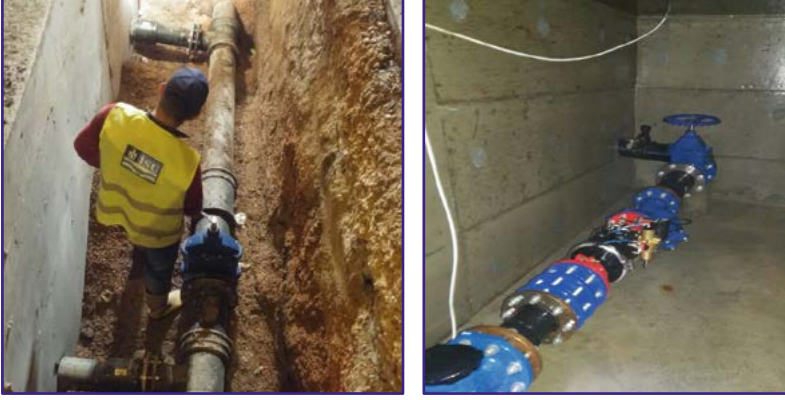
Şekil 3. Alt bölge odaları inşaatı ve basınç yönetimi için basınç düşürücü vana montajı
