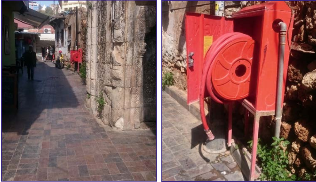
Şekil 6.5. Yasal olmayan şekilde kullanılan bir yangın dolabı (dolabın kapağı açık ve kullanım sonrası yolda ıslaklık)
