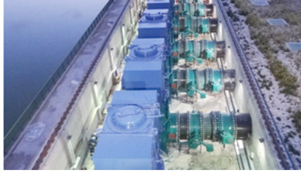
Şekil 7. Suruç Pompa İstasyonu.
