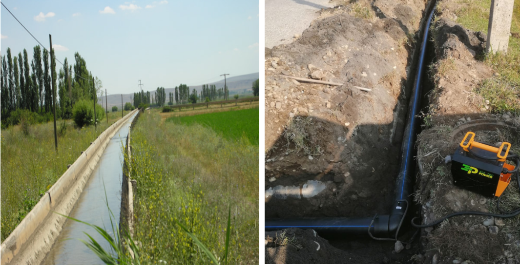
Şekil 9. Açık Kanal ve Kapalı PE100 Boru.
