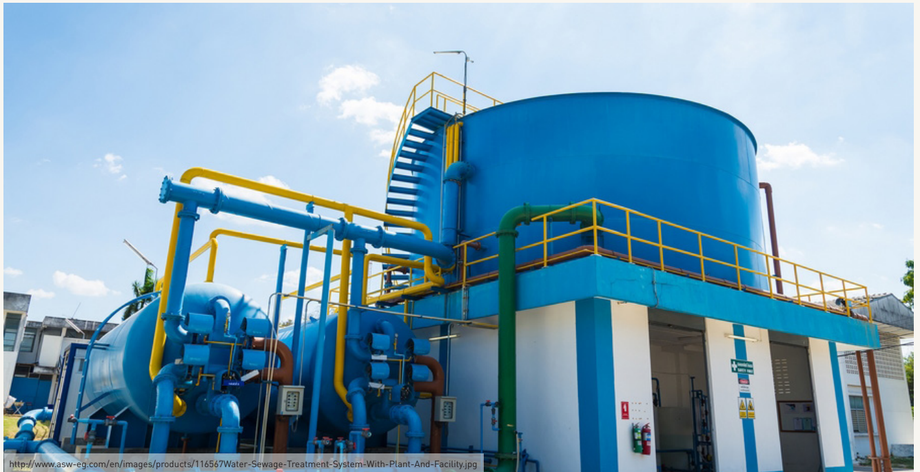
Endüstriyel Atıksu Arıtma Tesisi
