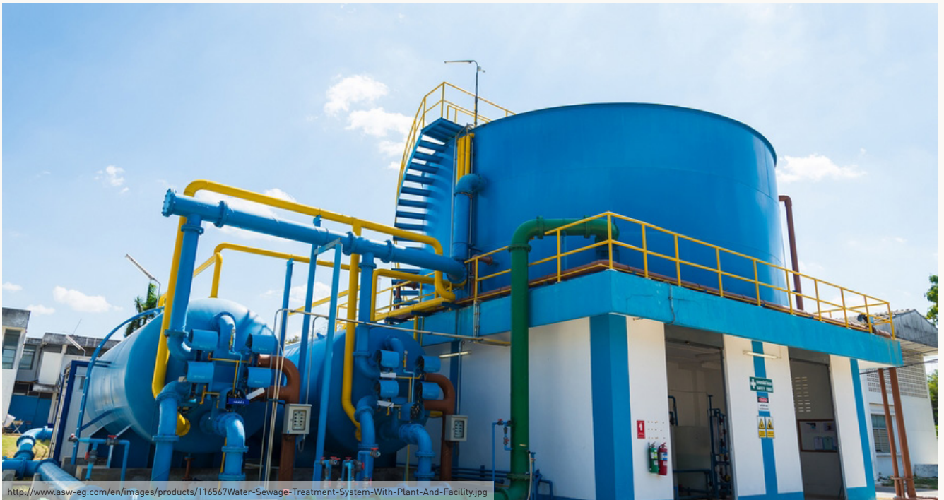
Endüstriyel Atıksu Arıtma Tesisi
