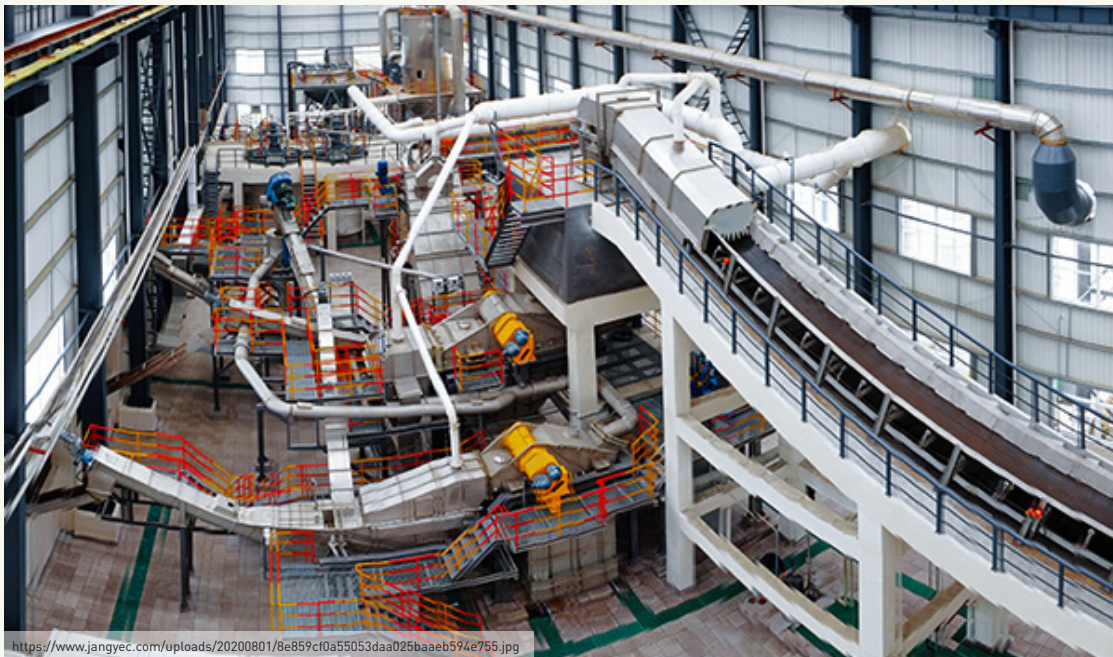
Atık Akülerden Kurşun Geri Kazanım Tesisinde Kırma ve Ayırma Sistemi
