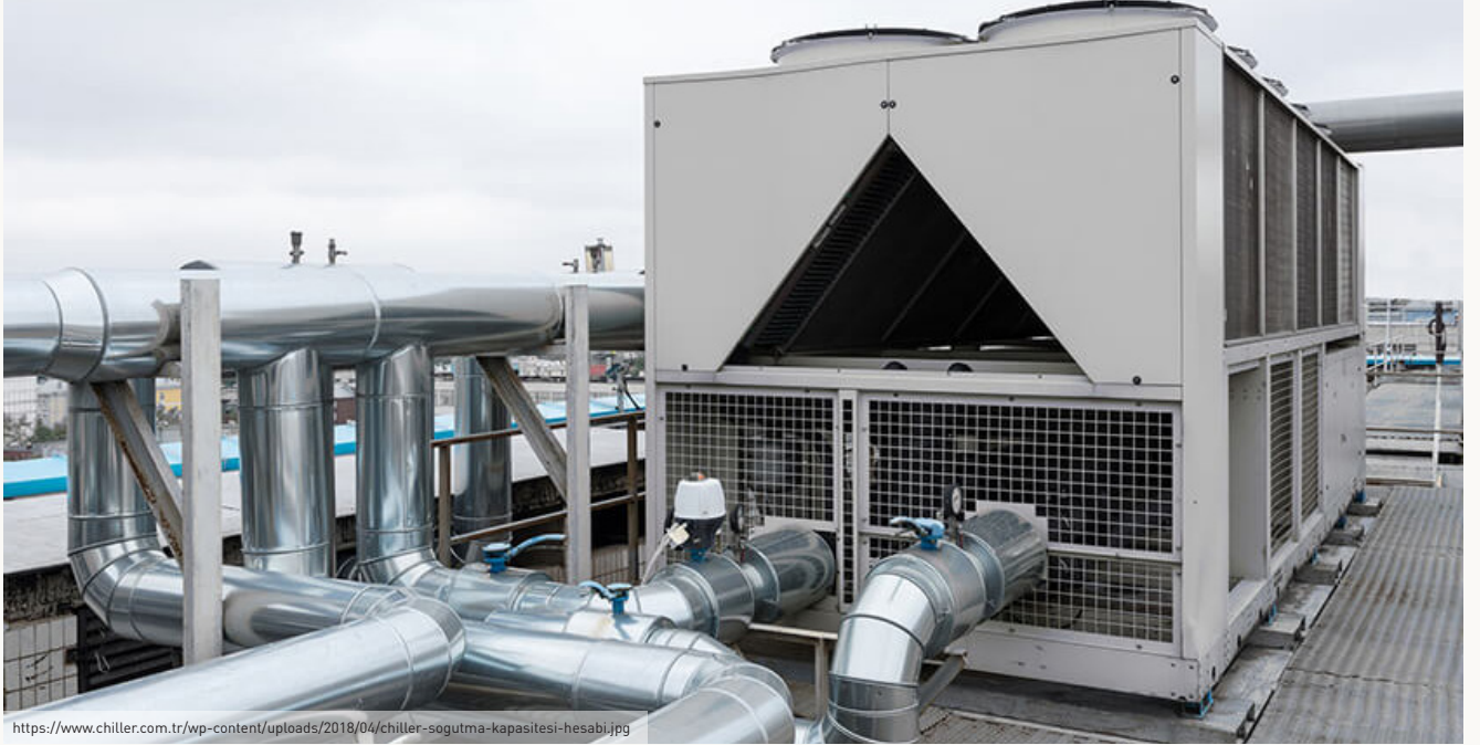
Soğutma Sistemleri (Chiller)
