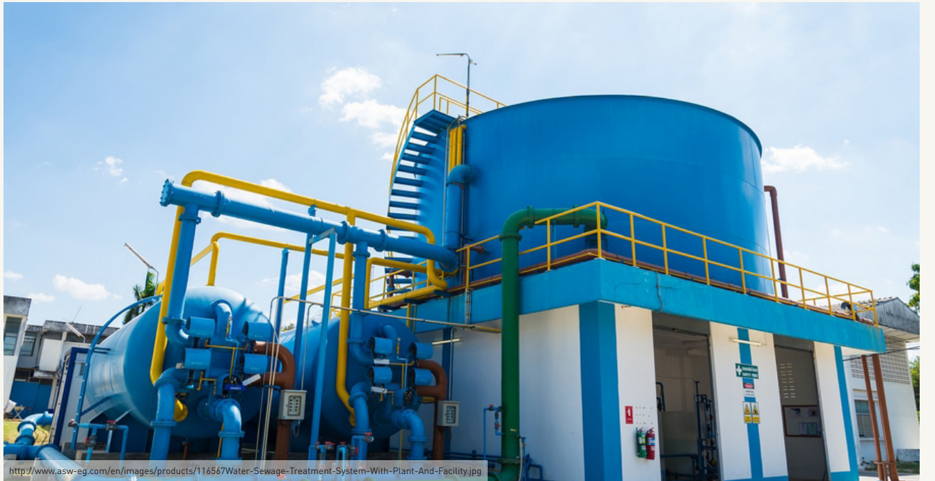
Endüstriyel Atıksu Arıtma Tesis
