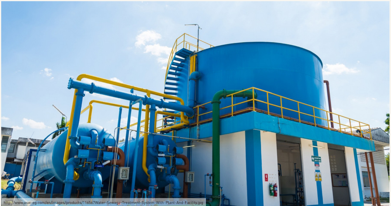
Endüstriyel Atıksu Arıtma Tesisi
