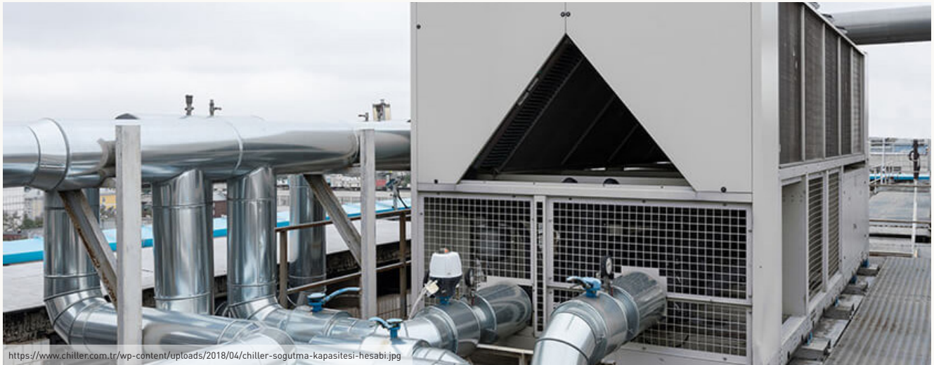
Soğutma Sistemleri (Chiller)
