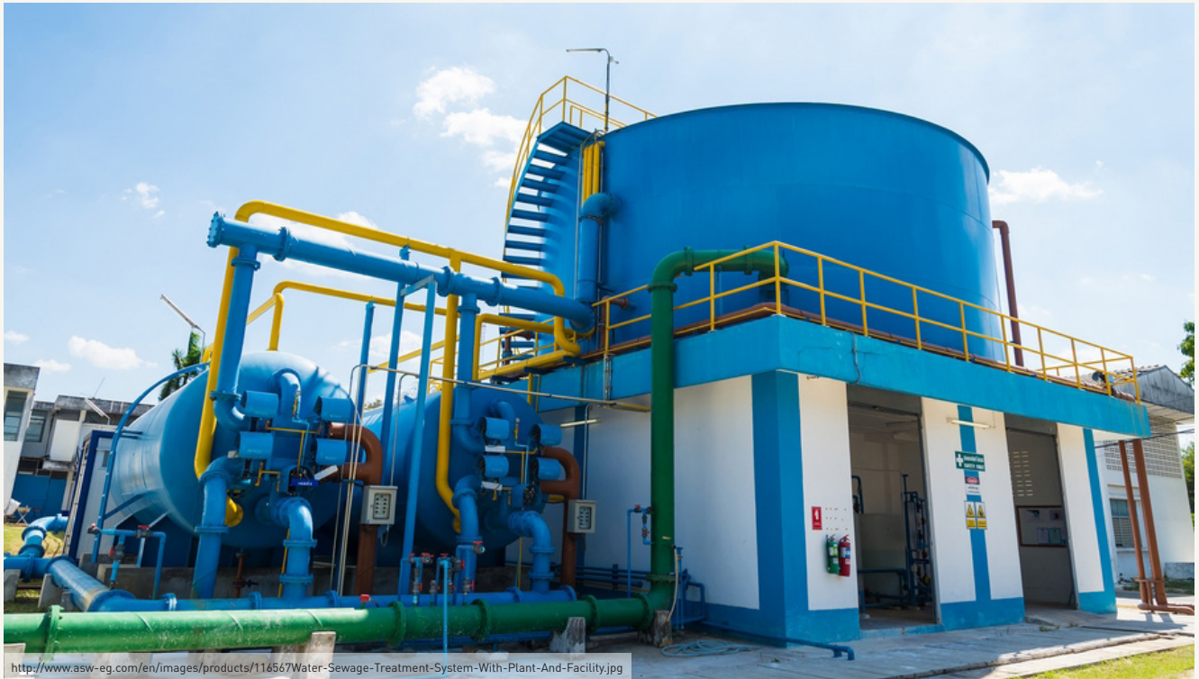
Endüstriyel Atıksu Arıtma Tesisi
