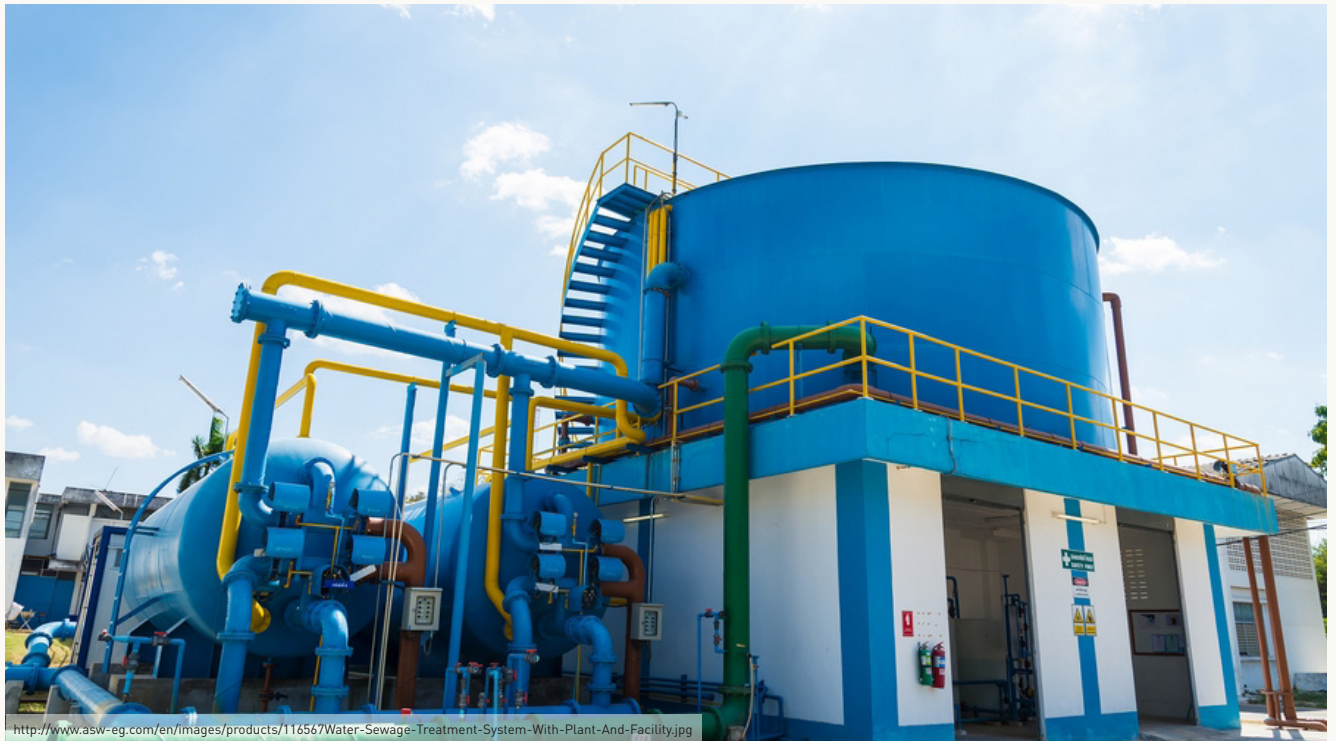
Endüstriyel Atıksu Arıtma Tesisi
