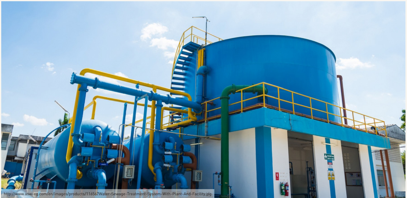
Endüstriyel Atıksu Arıtma Tesisi
