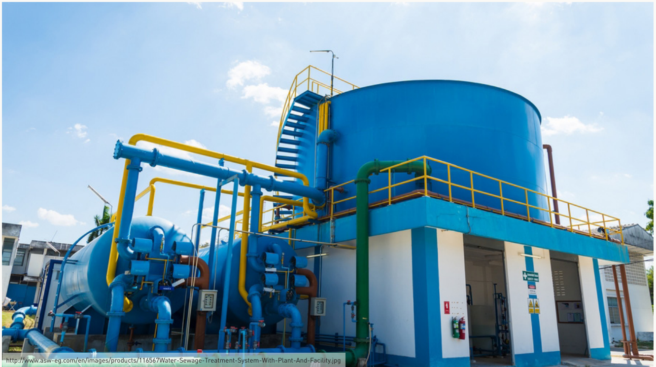
Endüstriyel Atıksu Arıtma Tesisi
