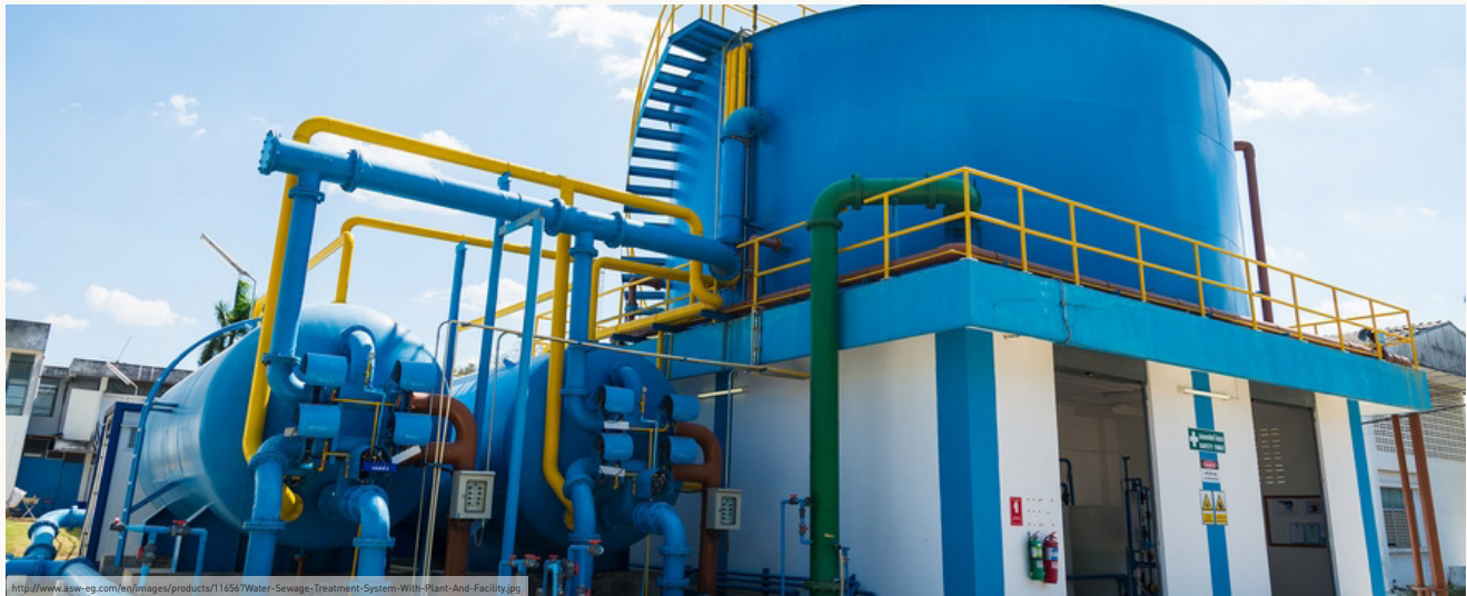
Endüstriyel Atıksu Arıtma Tesisi
