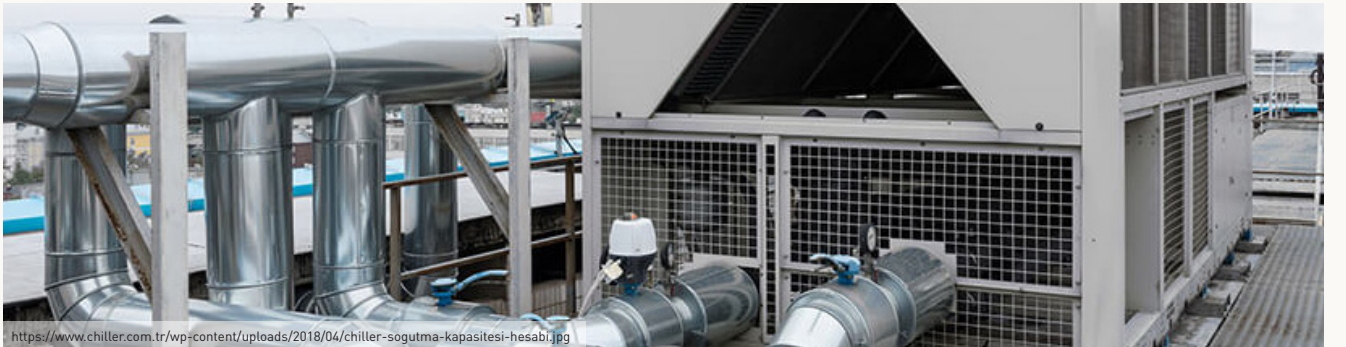
Soğutma Sistemleri (Chiller)
