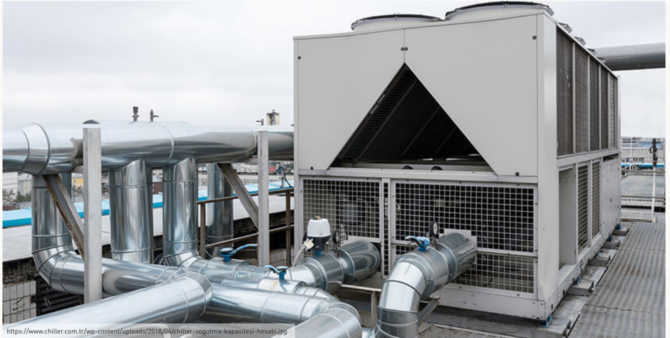
Soğutma Sistemleri (Chiller)
