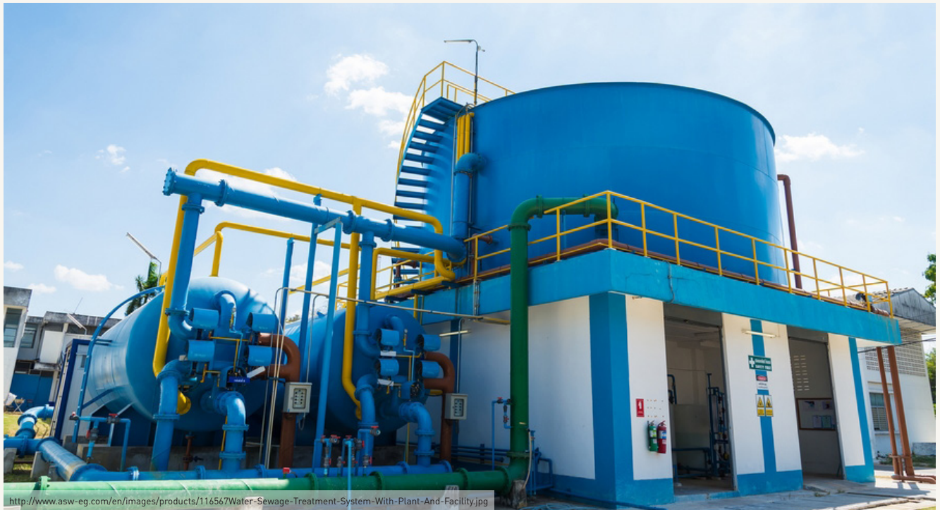
Endüstriyel Atıksu Arıtma Tesisi
