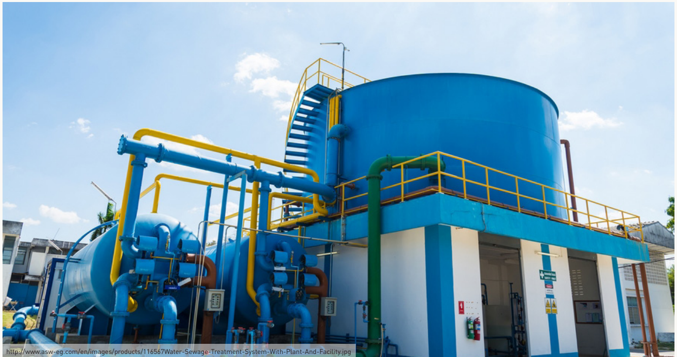
Endüstriyel Atıksu Arıtma Tesisi
