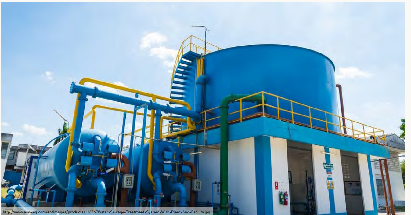
Endüstriyel Atıksu Arıtma Tesisi
