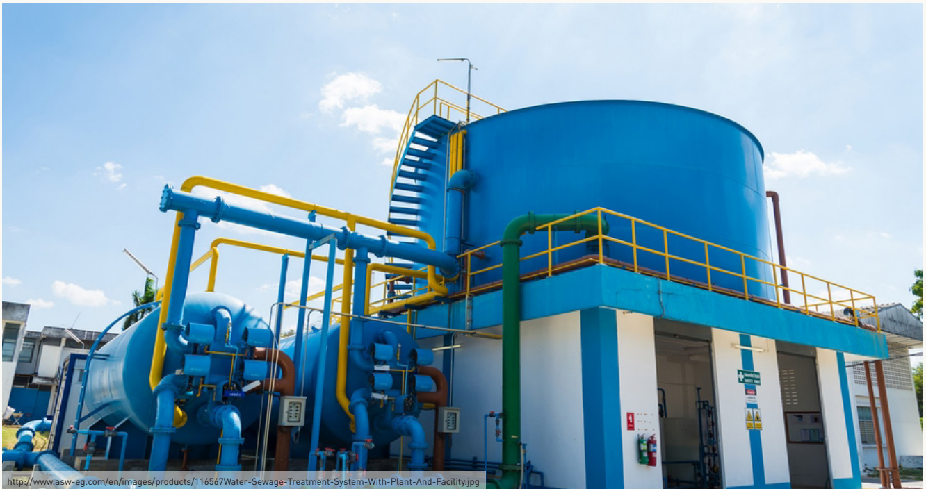
Endüstriyel Atıksu Arıtma Tesisi
