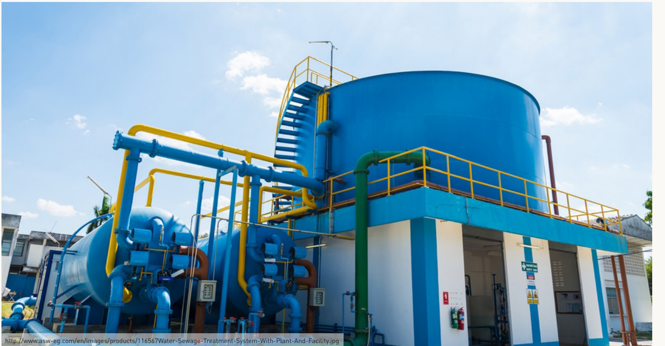
Endüstriyel Atıksu Arıtma Tesisi
