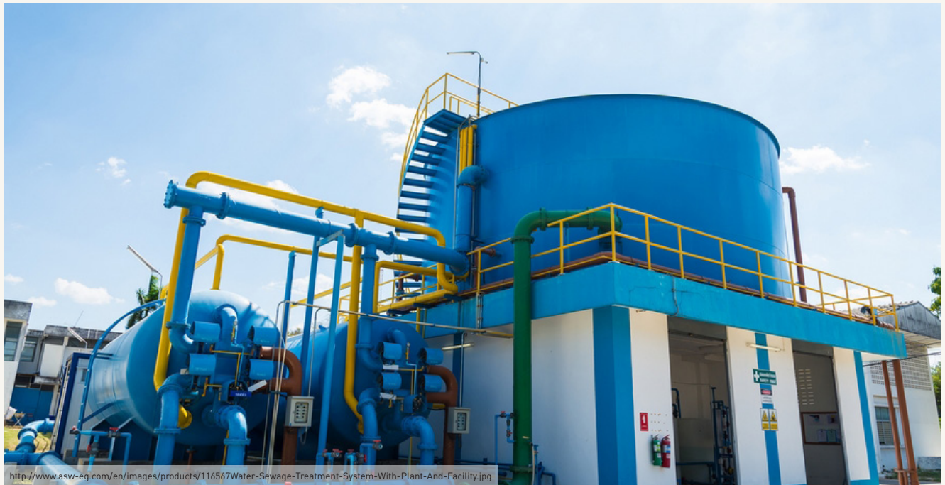
Endüstriyel Atıksu Arıtma Tesisi
