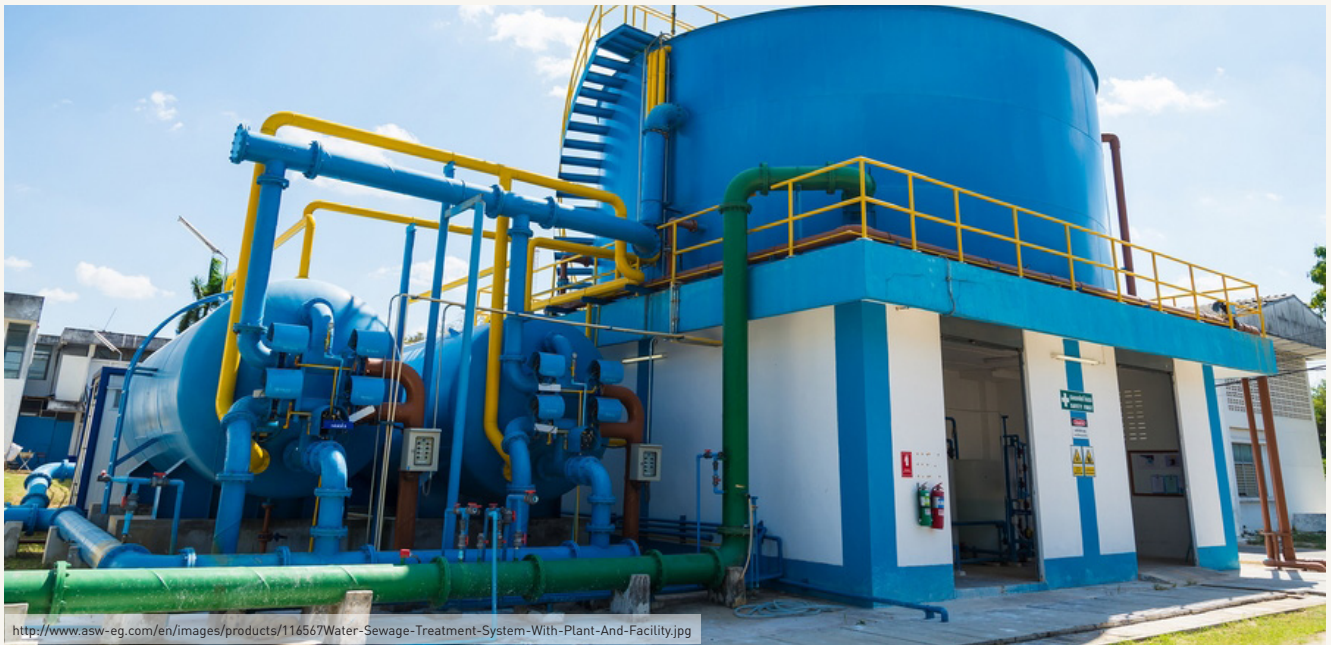
Endüstriyel Atıksu Arıtma Tesisi
