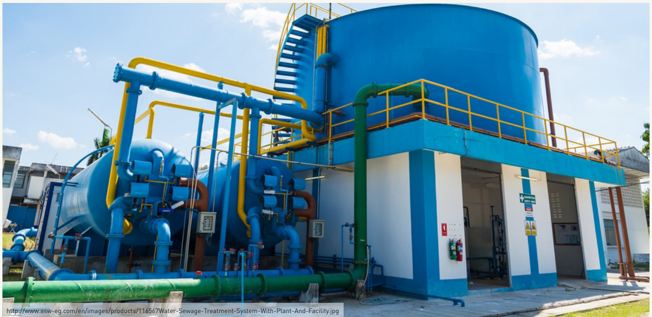
Endüstriyel Atıksu Arıtma Tesisi
