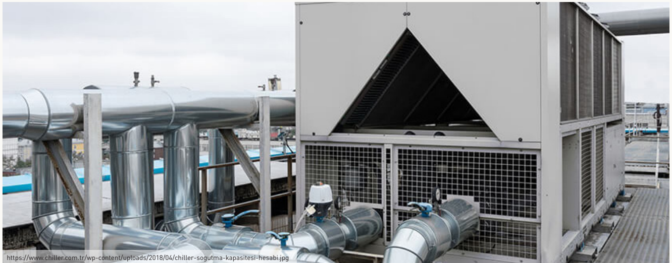
Soğutma Sistemleri (Chiller)
