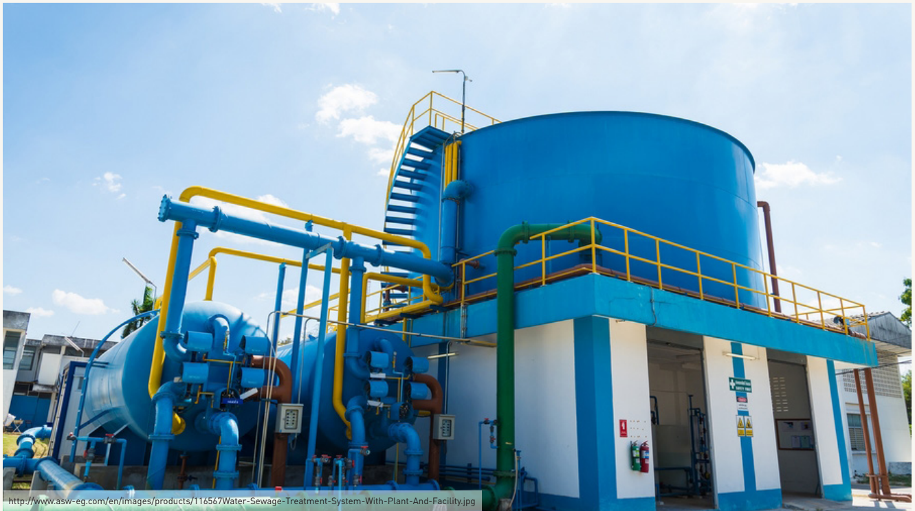
Endüstriyel Atıksu Arıtma Tesisi
