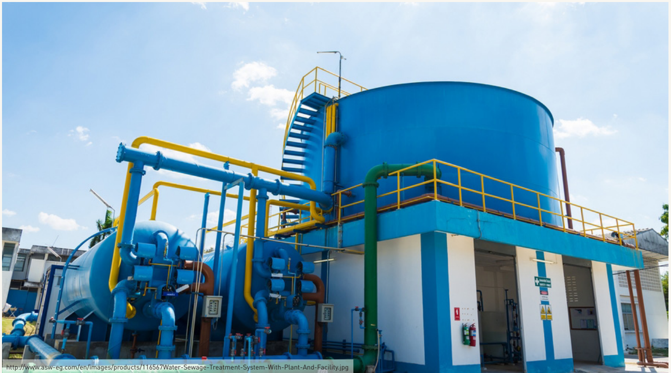
Endüstriyel Atıksu Arıtma Tesisi
