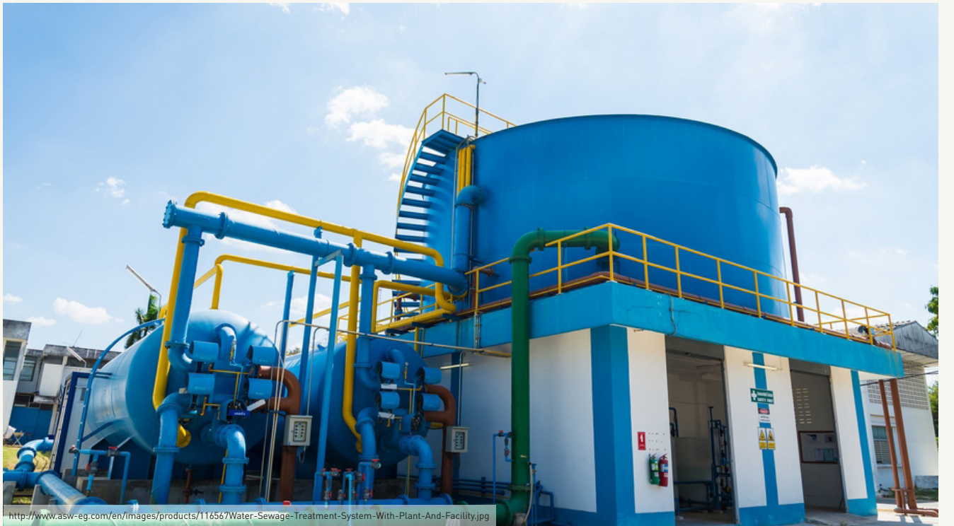
Endüstriyel Atıksu Arıtma Tesisi
