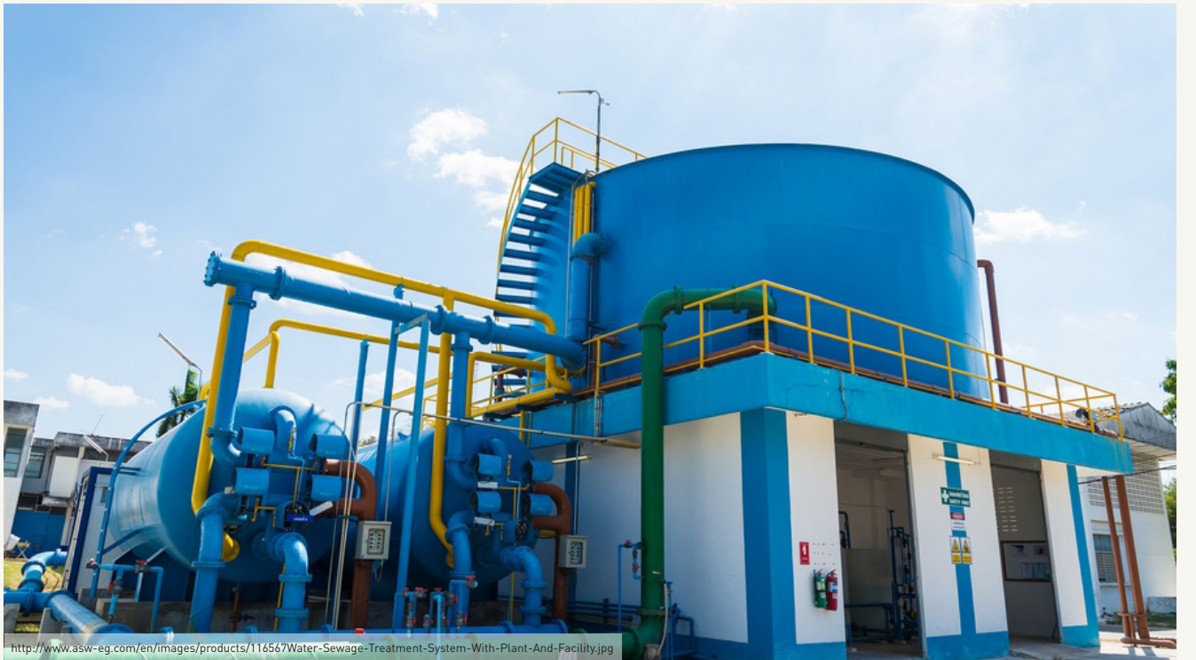
Endüstriyel Atıksu Arıtma Tesisi
