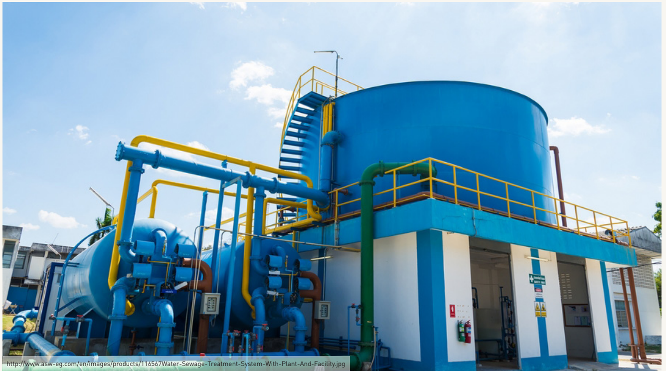
Endüstriyel Atıksu Arıtma Tesisi
