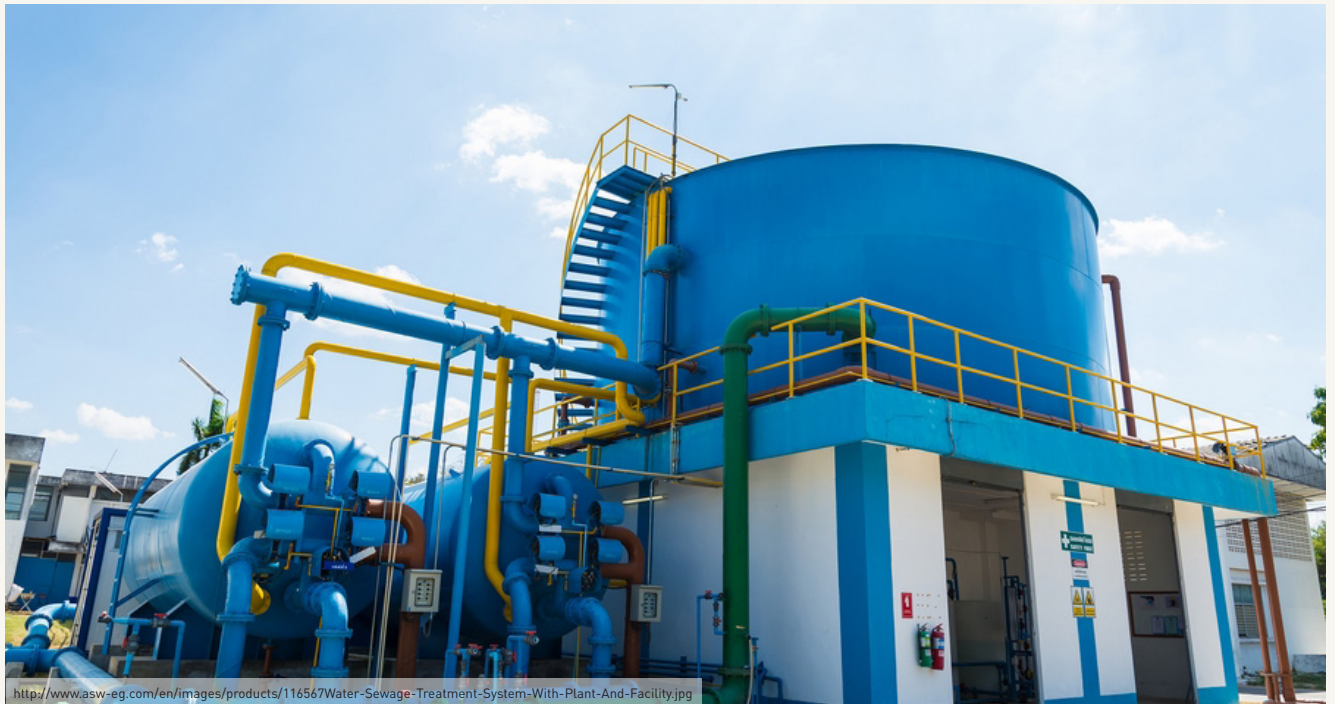
Endüstriyel Atıksu Arıtma Tesisi
