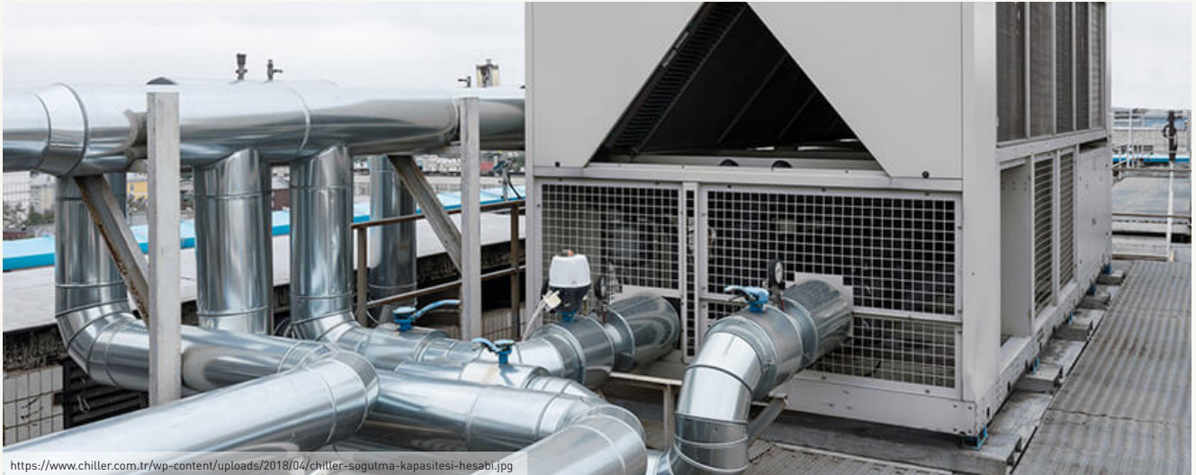
Soğutma Sistemleri (Chiller)
