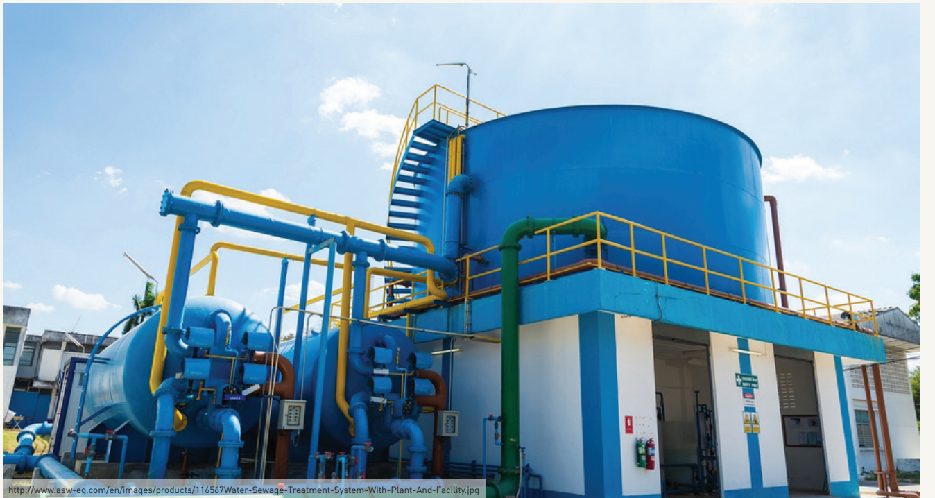
Endüstriyel Atıksu Arıtma Tesisi
