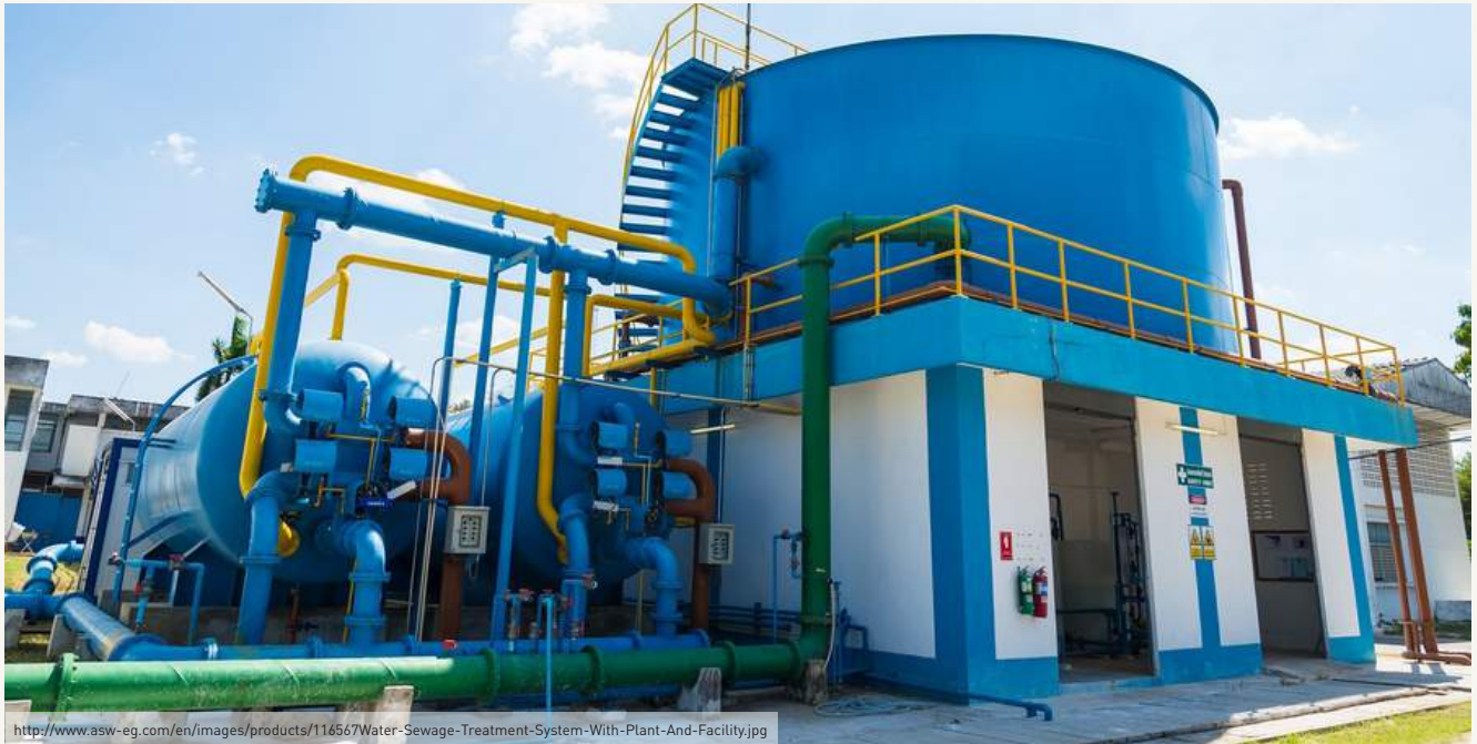
Endüstriyel Atıksu Arıtma Tesisi
