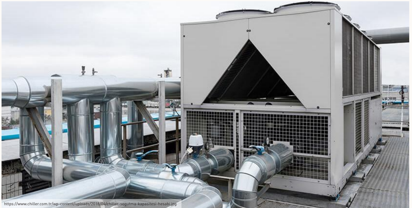
Soğutma Sistemleri (Chiller)
