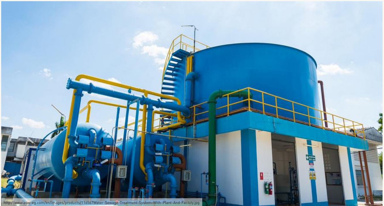
Endüstriyel Atıksu Arıtma Tesisi
