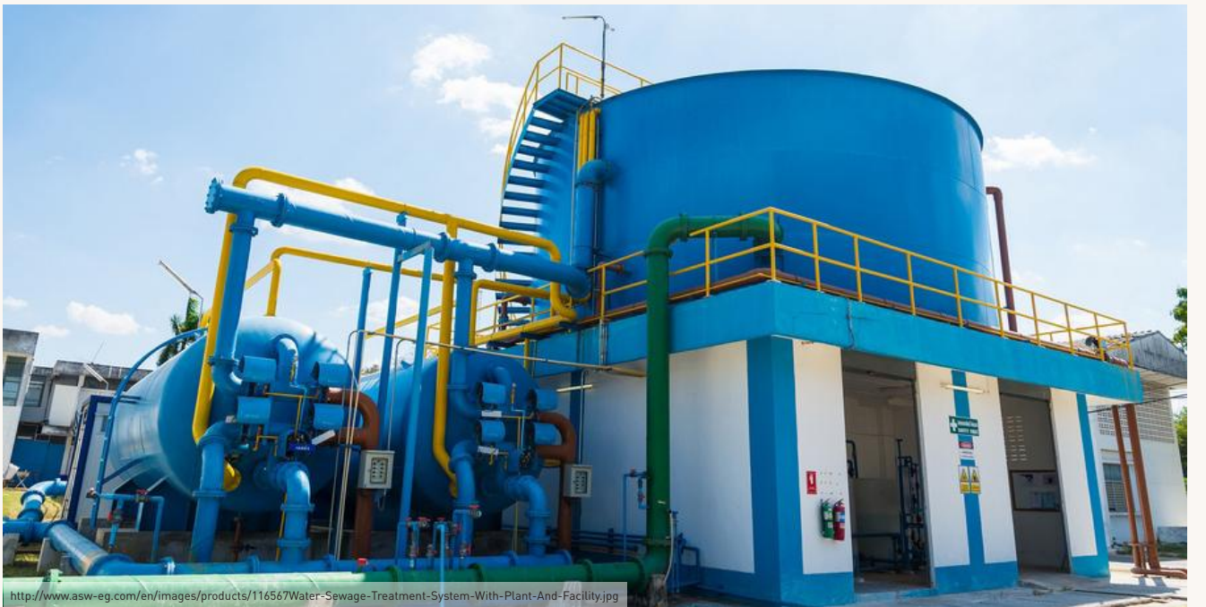
Endüstriyel Atıksu Arıtma Tesisi
