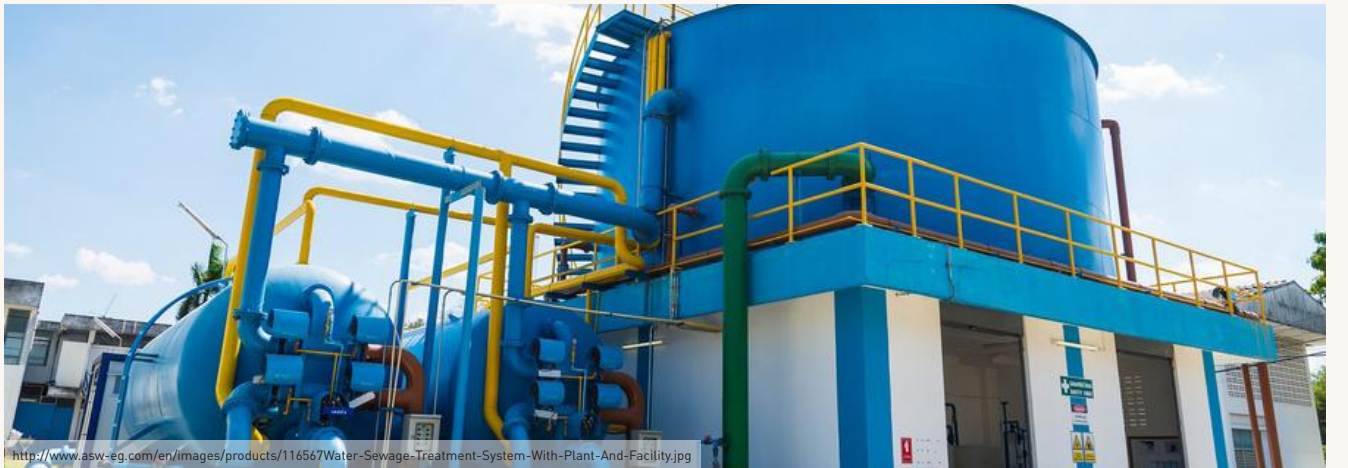
Endüstriyel Atıksu Arıtma Tesisi
