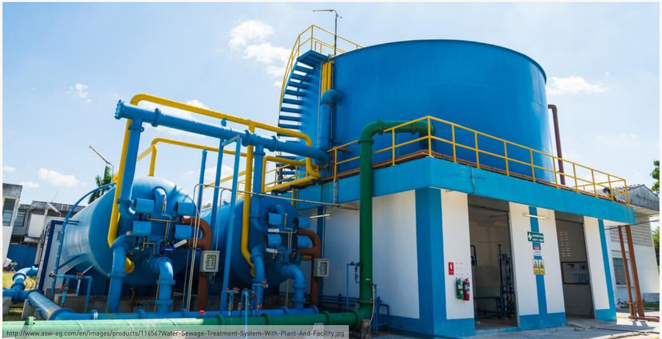
Endüstriyel Atıksu Arıtma Tesisi
