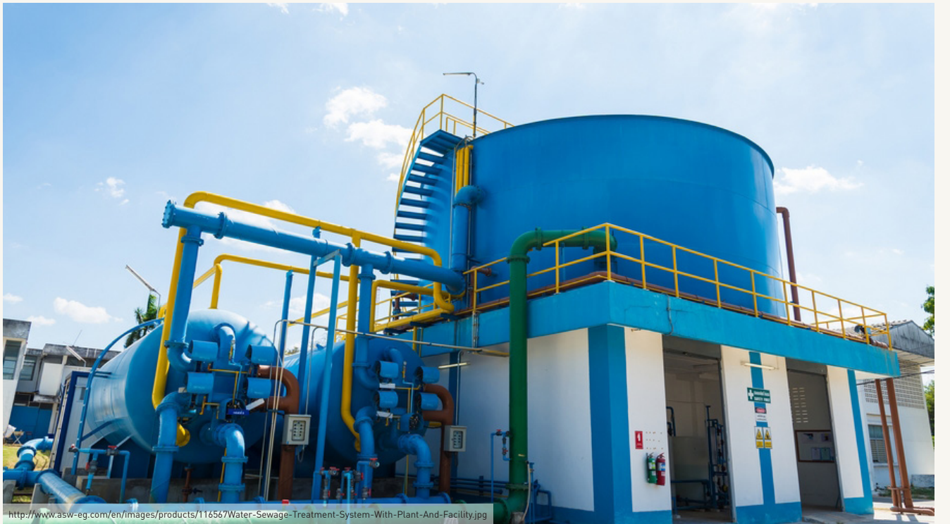
Endüstriyel Atıksu Arıtma Tesisi
