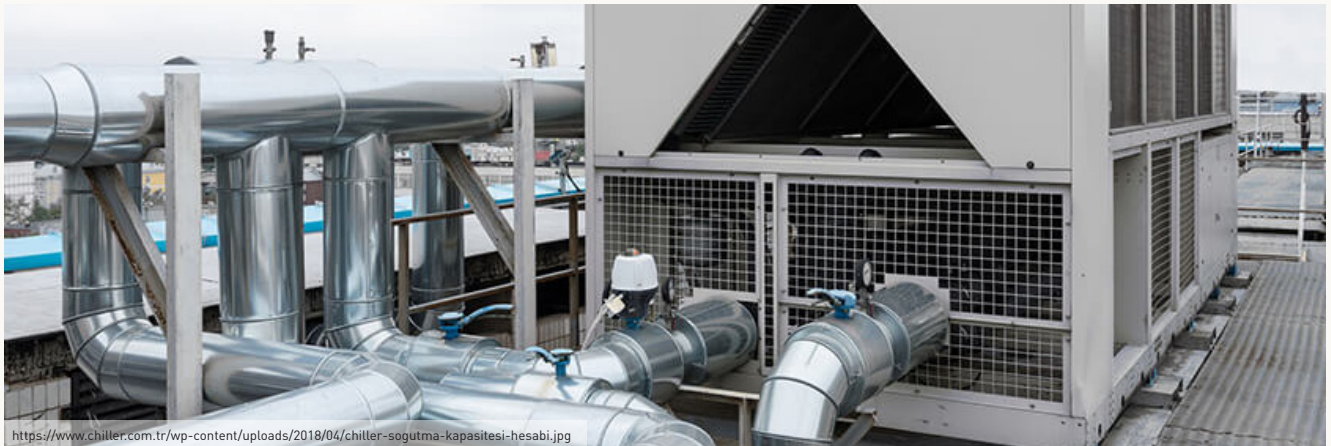
Soğutma Sistemleri (Chiller)
