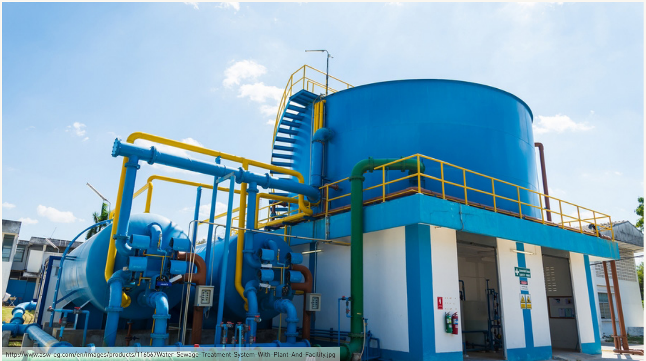
Endüstriyel Atıksu Arıtma Tesisi
