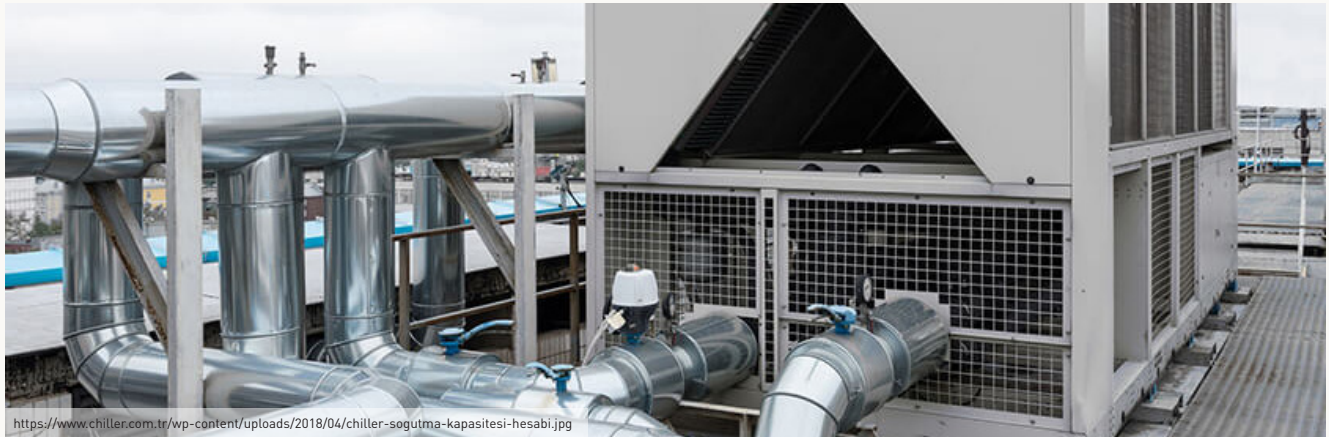
Soğutma Sistemleri (Chiller)
