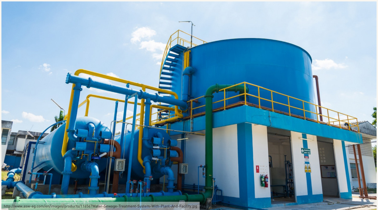
Endüstriyel Atıksu Arıtma Tesisi
