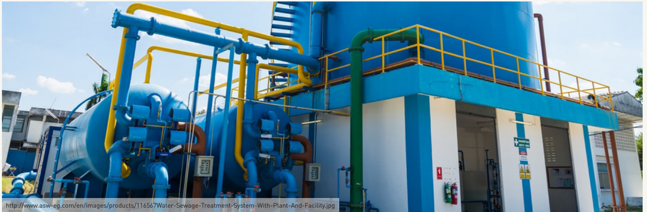
Endüstriyel Atıksu Arıtma Tesisi
