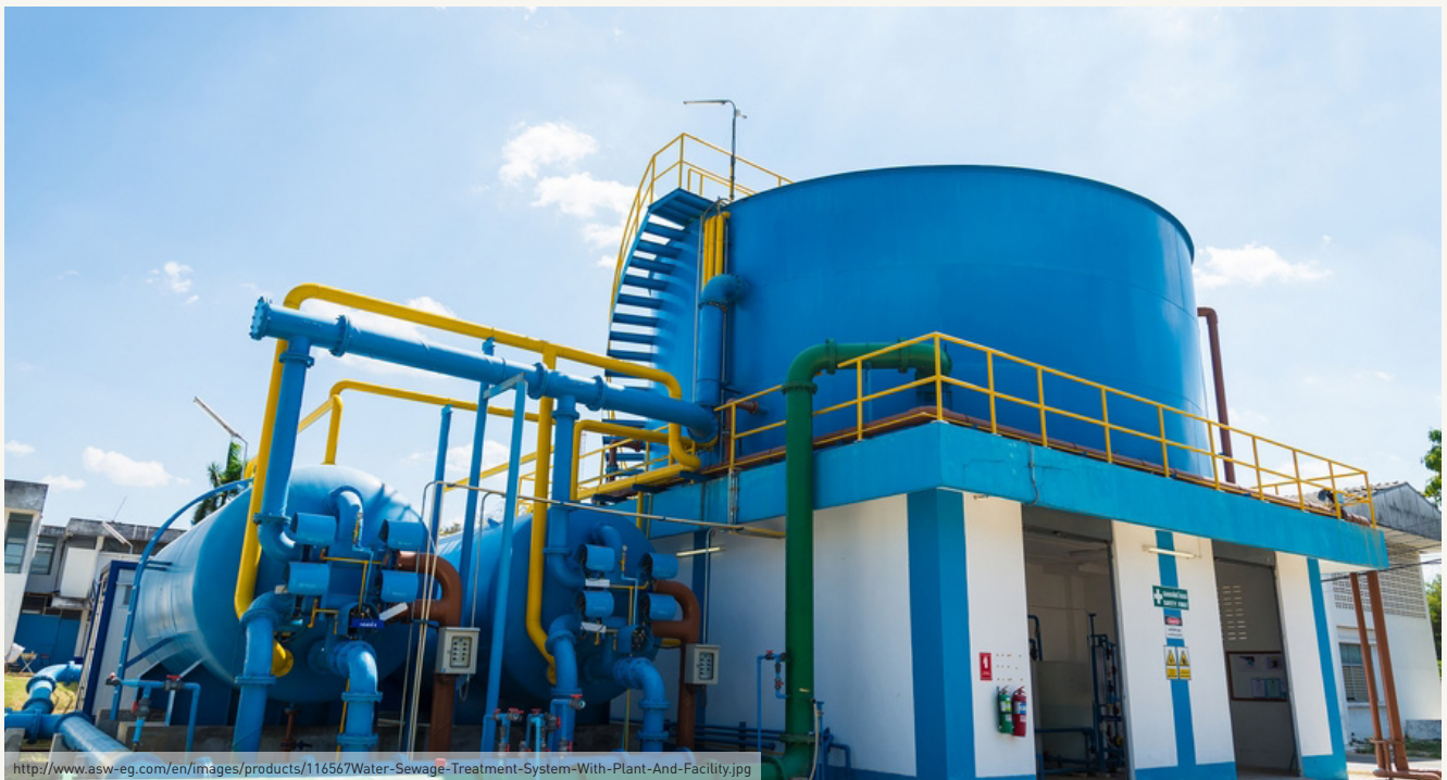
Endüstriyel Atıksu Arıtma Tesisi
