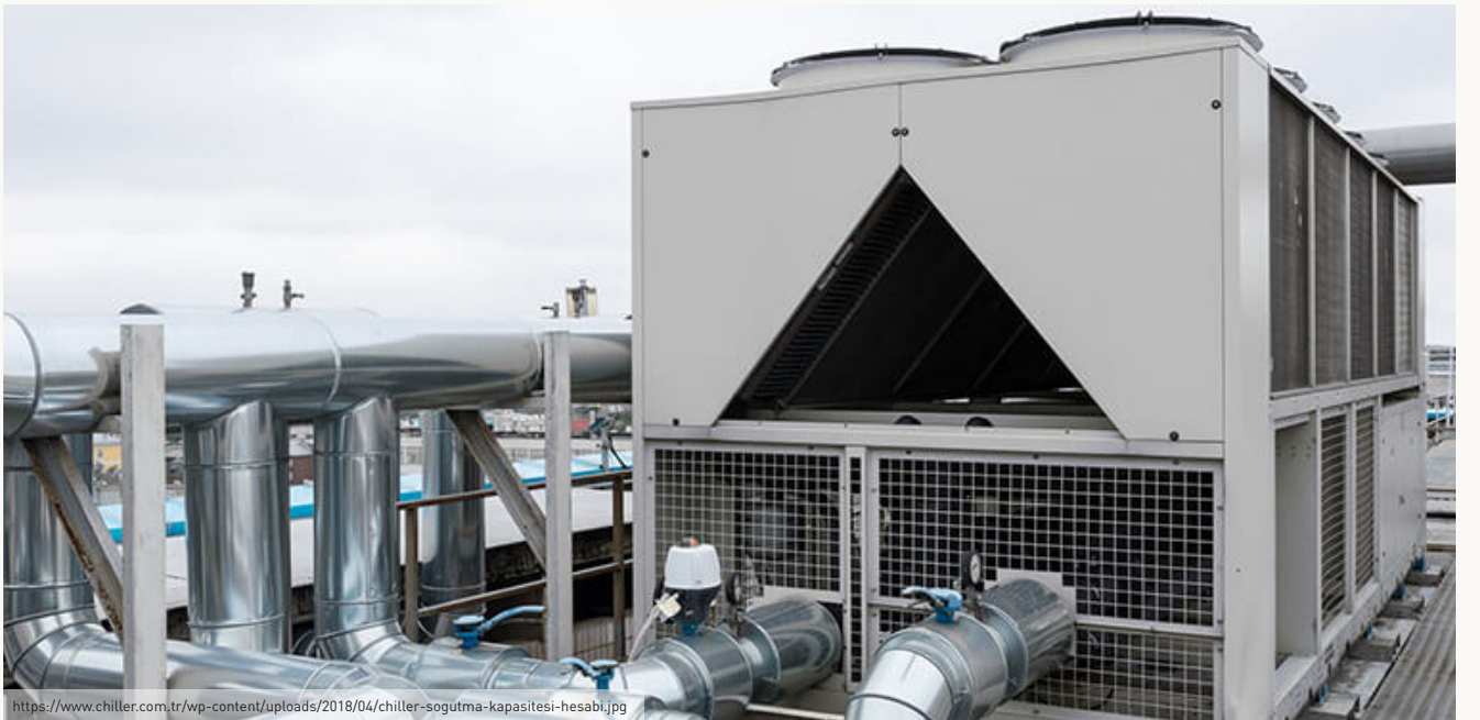
Soğutma Sistemleri (Chiller)
