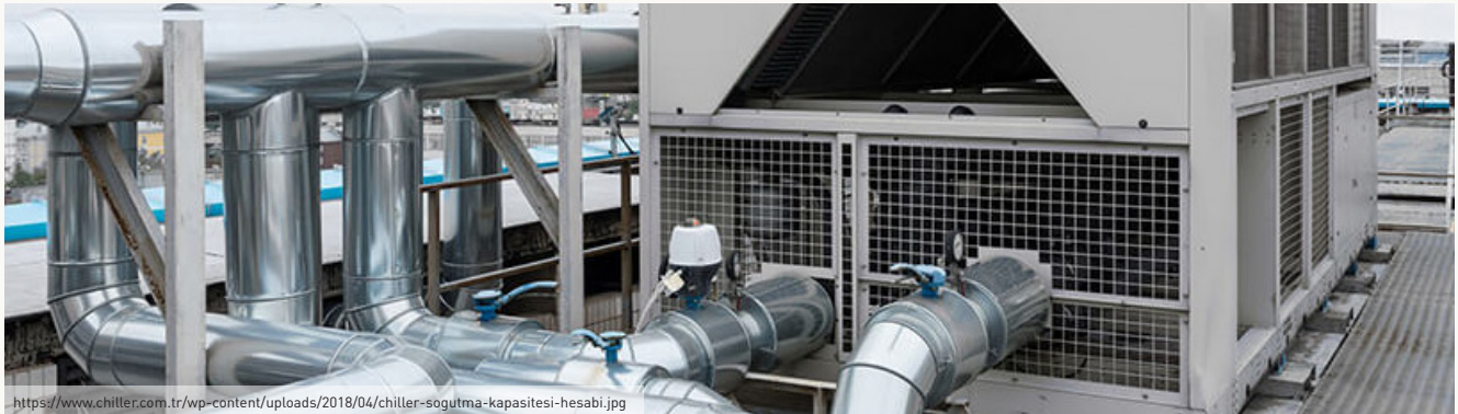
Soğutma Sistemleri (Chiller)
