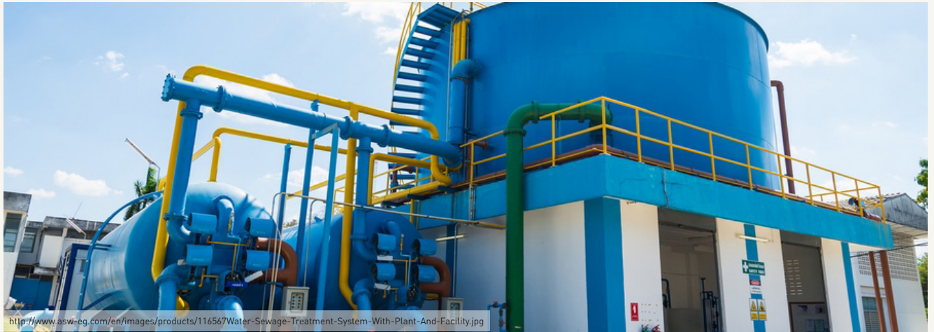
Endüstriyel Atıksu Arıtma Tesisi
