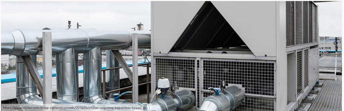
Soğutma Sistemleri (Chiller)
