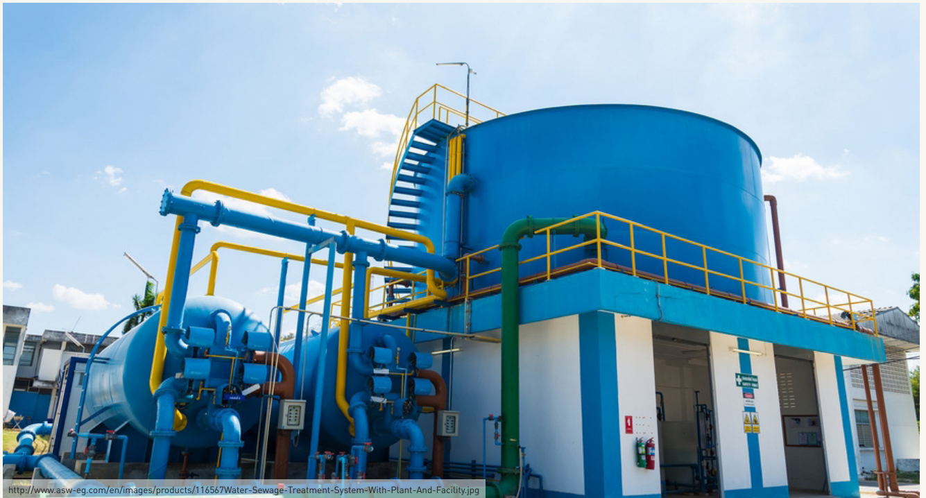
Endüstriyel Atıksu Arıtma Tesisi
