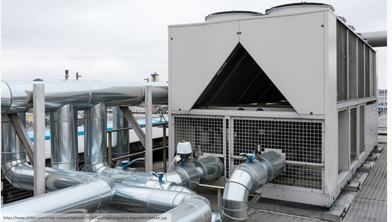
Soğutma Sistemleri (Chiller)
