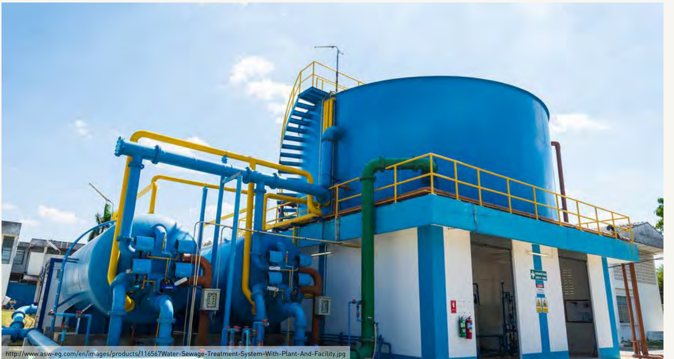
Endüstriyel Atıksu Arıtma Tesisi
