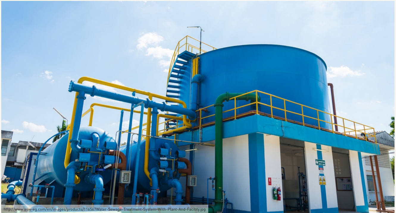
Endüstriyel Atıksu Arıtma Tesisi
