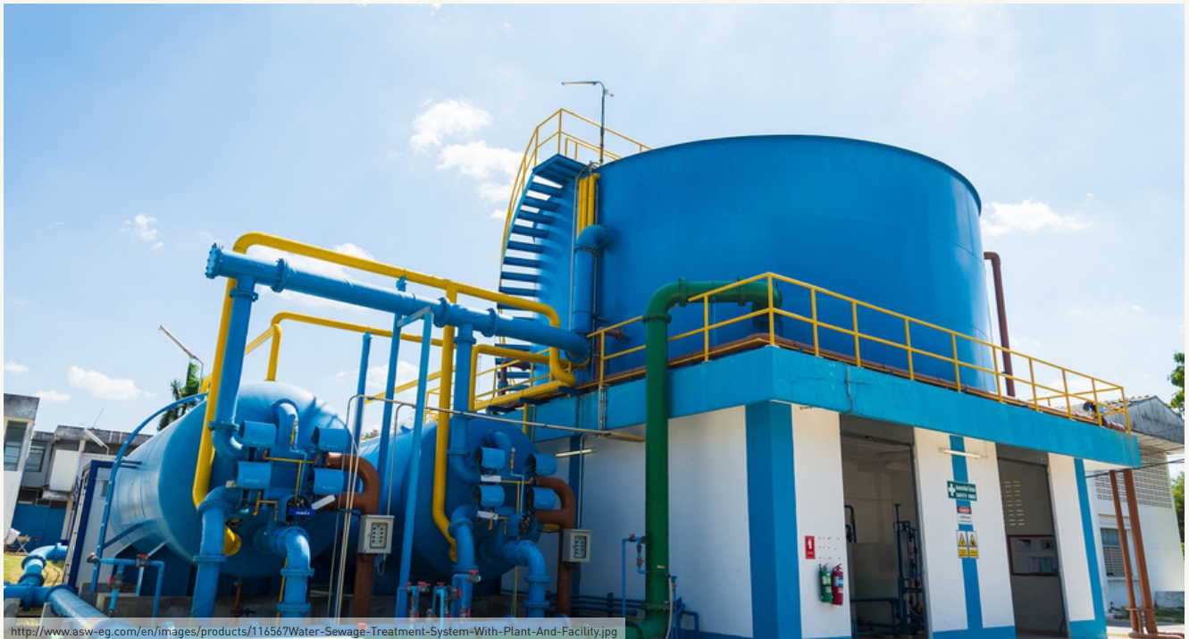
Endüstriyel Atıksu Arıtma Tesisi
