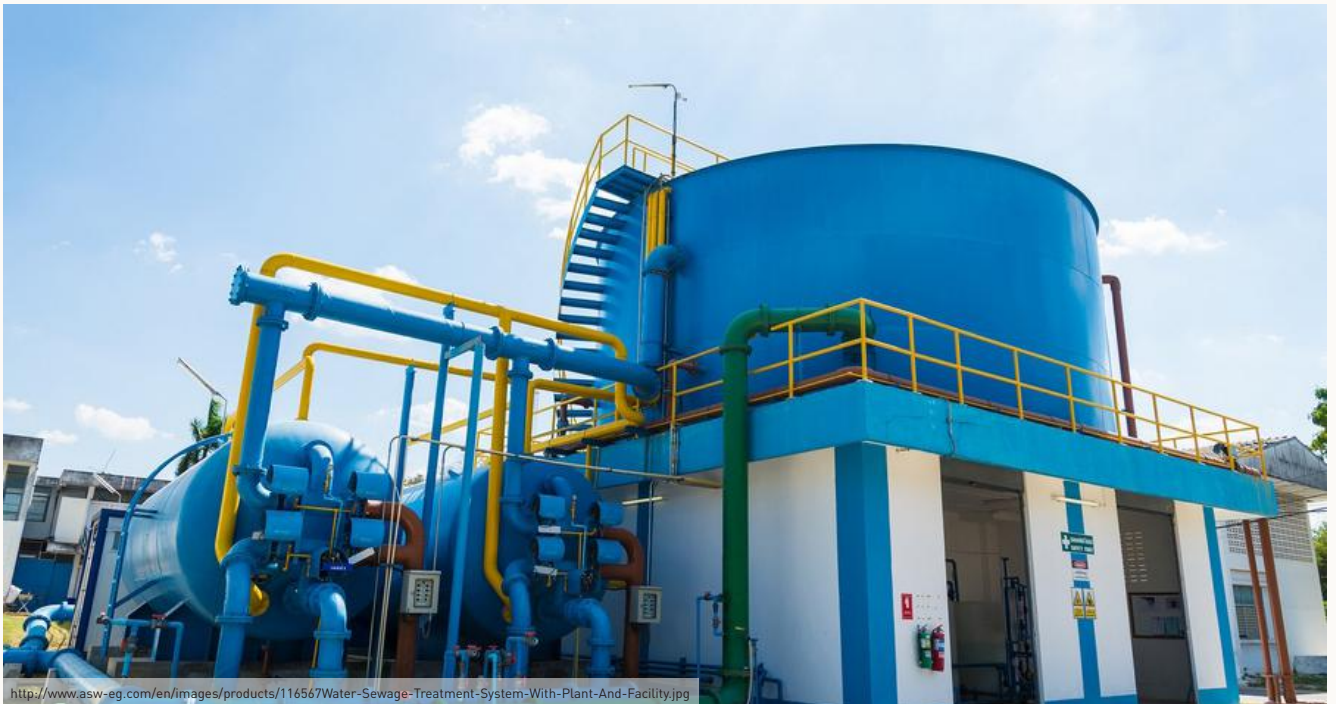
Endüstriyel Atıksu Arıtma Tesisi
