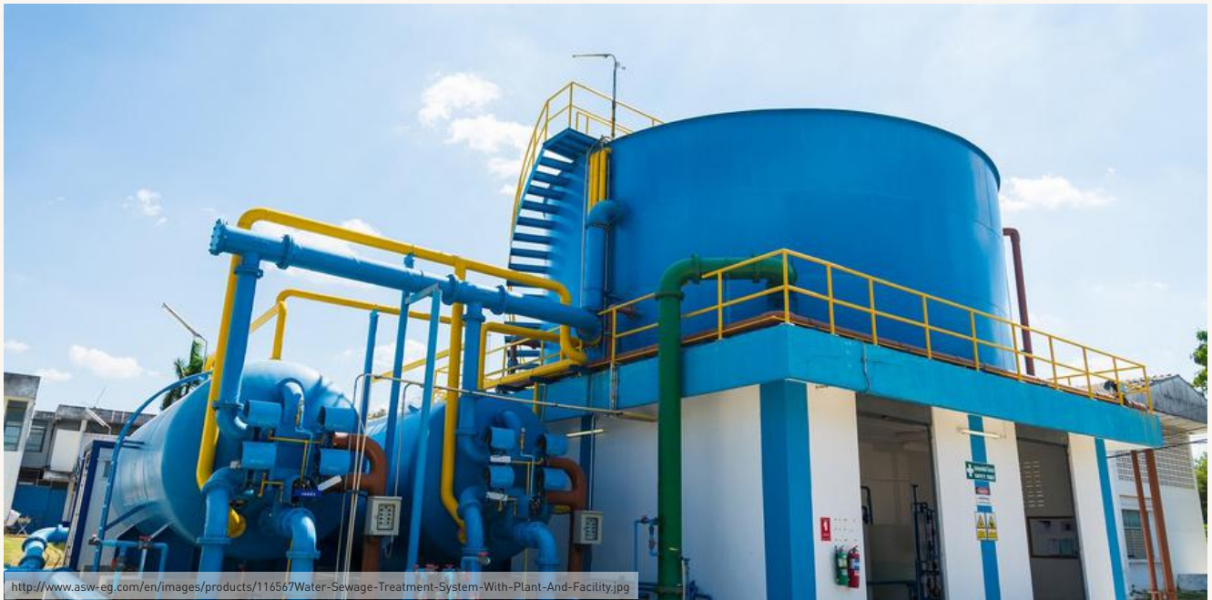
Endüstriyel Atıksu Arıtma Tesisi
