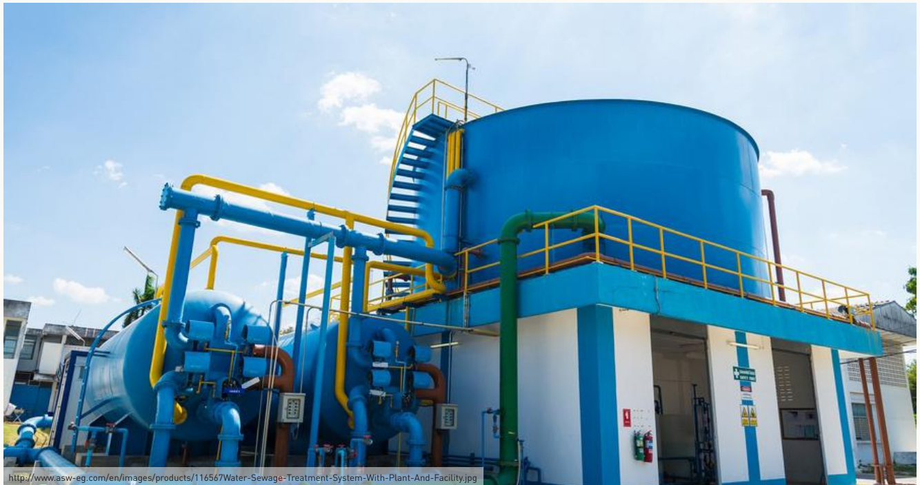
Endüstriyel Atıksu Arıtma Tesisi
